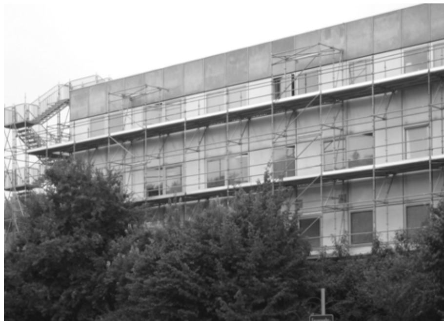
Abbildung 3: Baugerüst als provisorischer Flucht- und Rettungsweg
