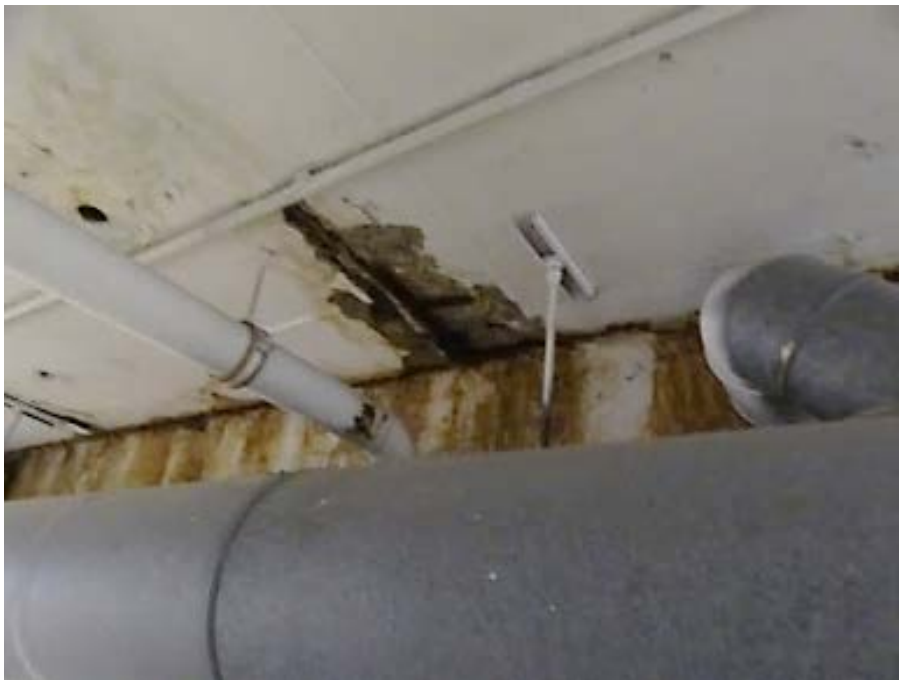
Abbildung 1: Schäden an Konstruktion und Technik durch undichtes Schwimmbecken
