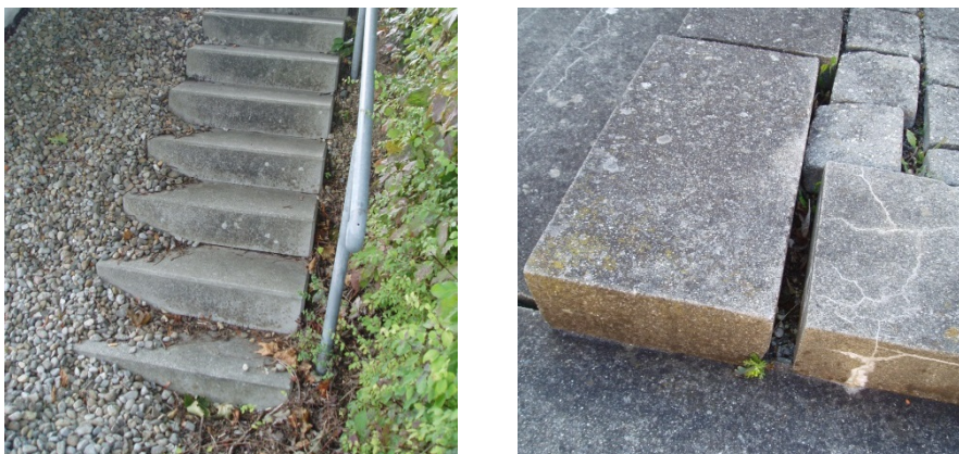
Abbildung 2: Mangelhafter Unterhalt und Pflege von Treppen
