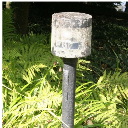
Abbildung 3: Nicht gereinigte Außenleuchten
