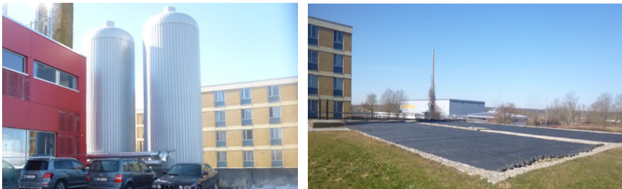
Abbildung 2: Hochtemperatur-Wärmespeicher (links), Solarabsorber (rechts)
